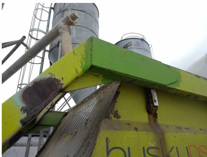
Obrázek č. 21 – Často opravované místo MKV zdroj: autor
