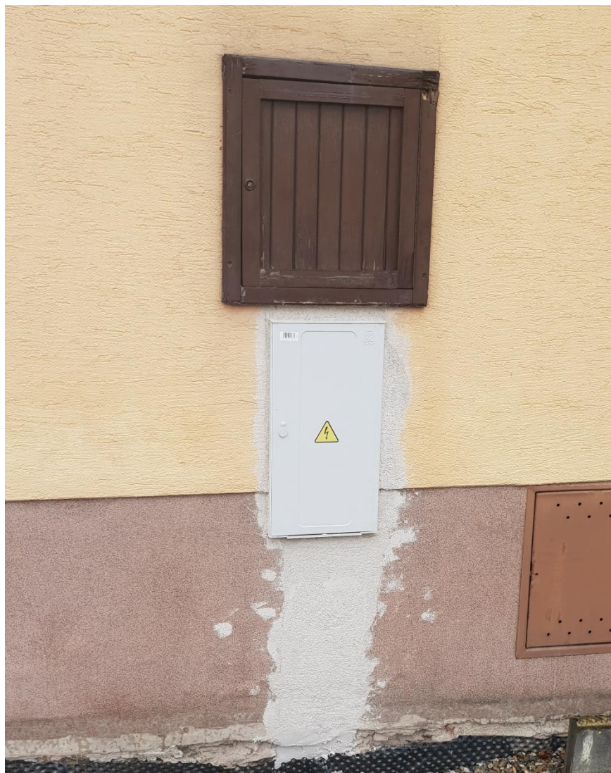
Obrázek 44 – Kabelová skříň na stěně
