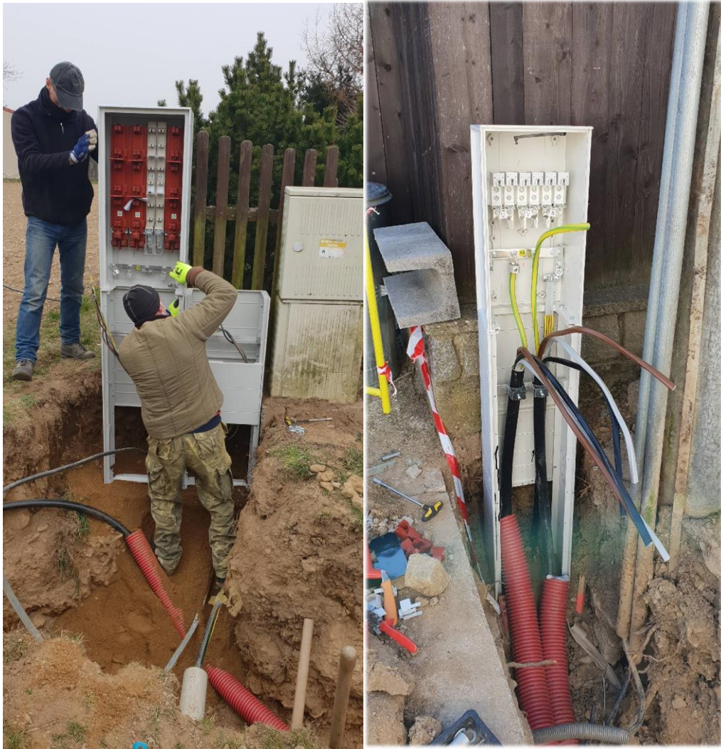
Obrázek 42 - Zapojení kompaktního pilíře
