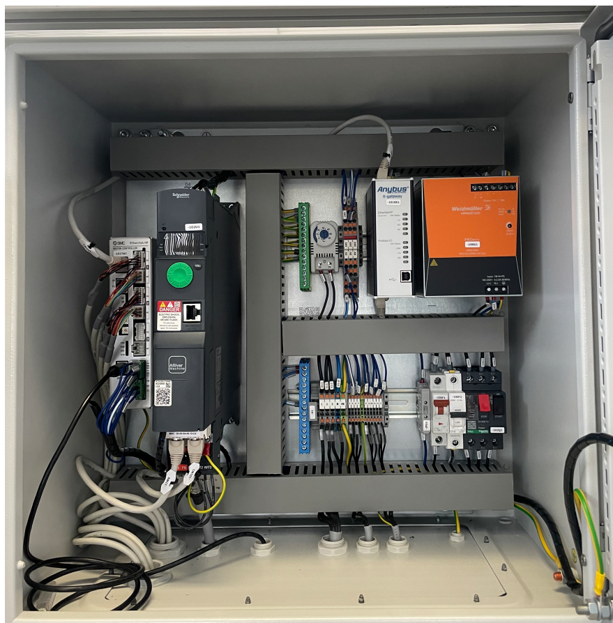
Obr. 4.8: Rozvaděč s pohybovou částí
