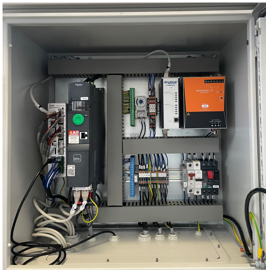
Obr. 4.8: Rozvaděč s pohybovou částí
