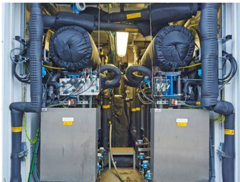
Obrázek 7: Vnitřek vodíkové čerpací stanice
