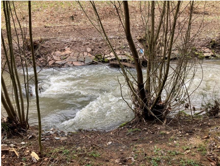
Obr.17: Vymleté břehy a staré opevnění v první části řešeného úseku (Pospíšilová, 2023).
