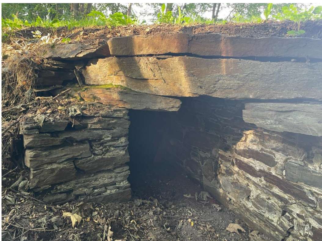
Obrázek P4 – Propustek u druhé strany místní komunikace
