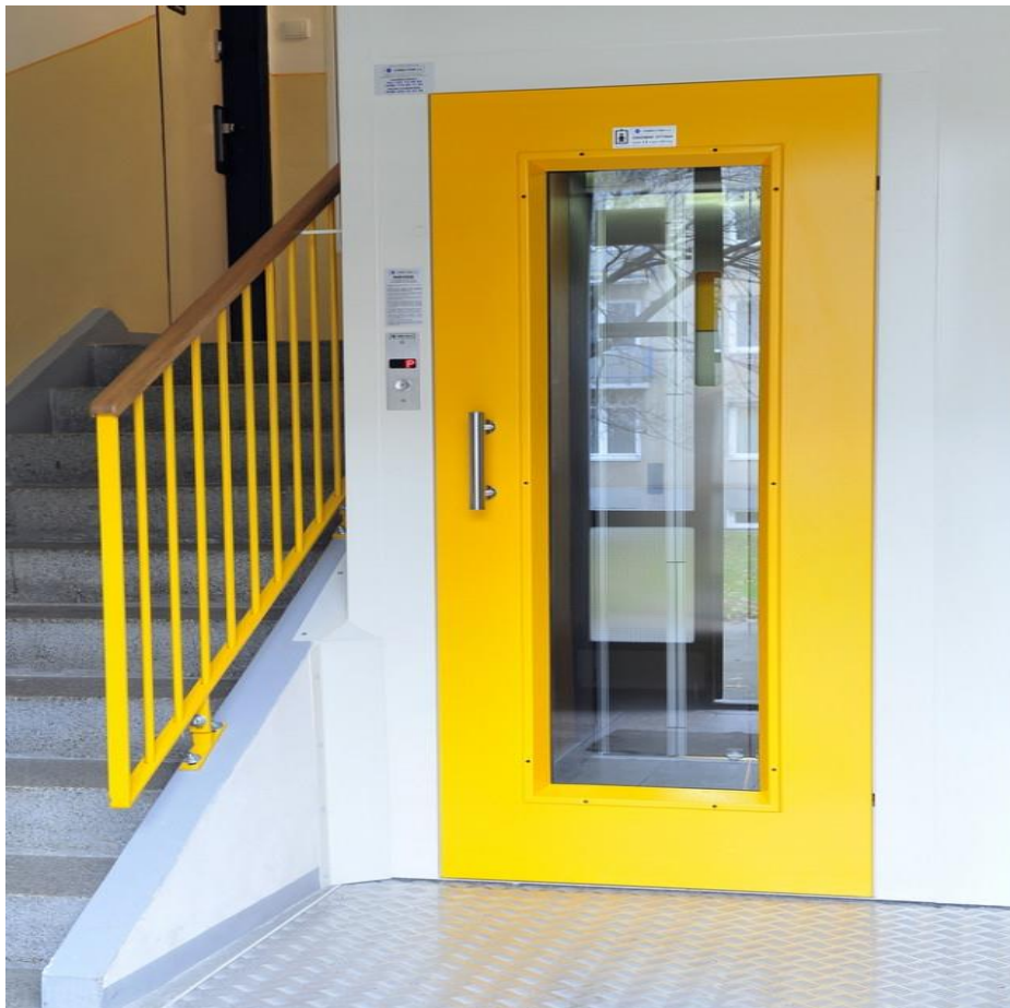
Obrázek 9: Osobní výtah společnosti Ctibůrek výtahy s. r. o.
