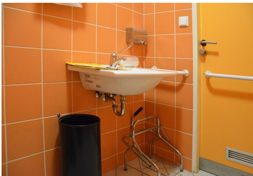
Obr. 23 Toalety pro tělesně postižené v budově Městského úřadu Prahy 9.
