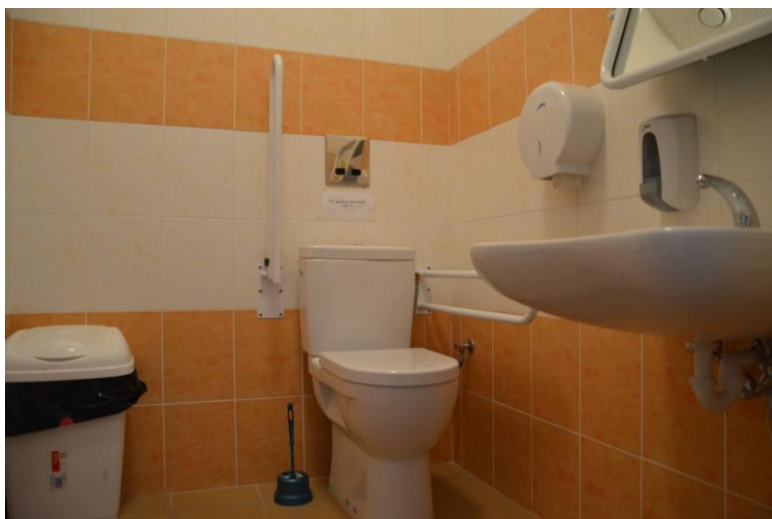
Obr.24 Toaleta pro tělesně postižené v budově Městského úřadu Prahy 10. Chybí zde např. svislé madlo u umyvadla.
