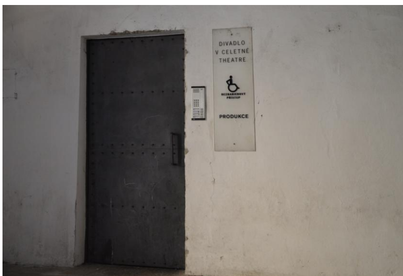
Obr. 15 Označený boční vstup do divadla V Celetné na Praze 1. Zvonek pro přivolání obsluhy není ve vyhovující výšce.
