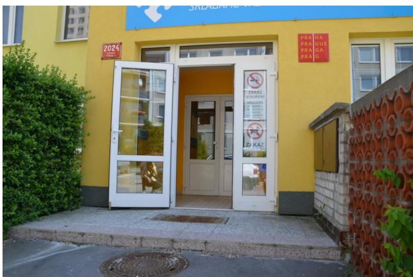
Obr.2 Vstup do Domu dětí a mládeže na Praze 4. Schod před vstupními dveřmi vyšší než 200 mm bez rampy či jiné bezbariérové úpravy.
