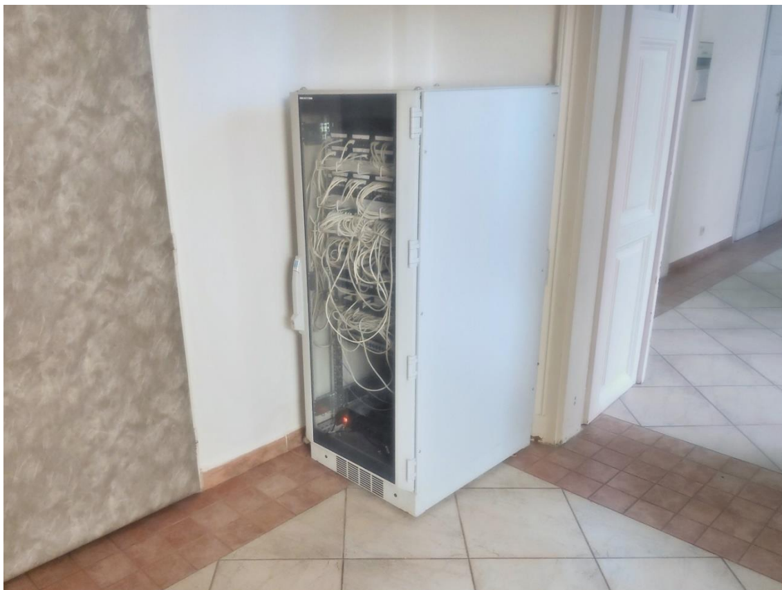
Obrázek č. 17: Rack v místnosti č. 112-A na chodbě v 2. NP před učebnami 112 a 113
