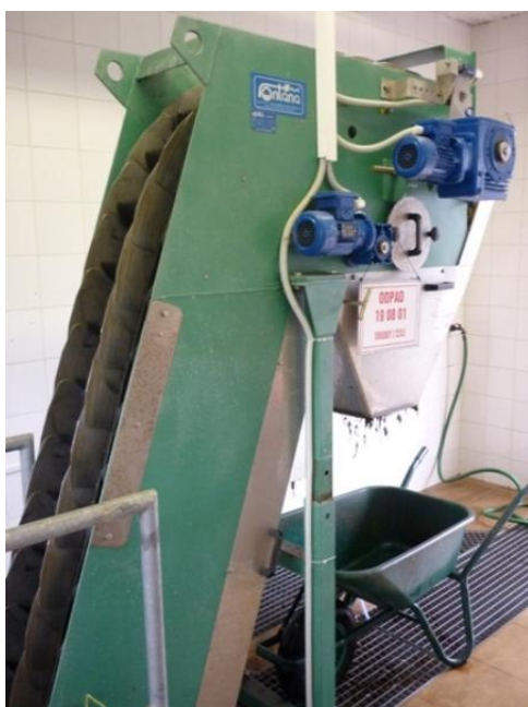
Obr. č. 3: Strojně stírané česle
