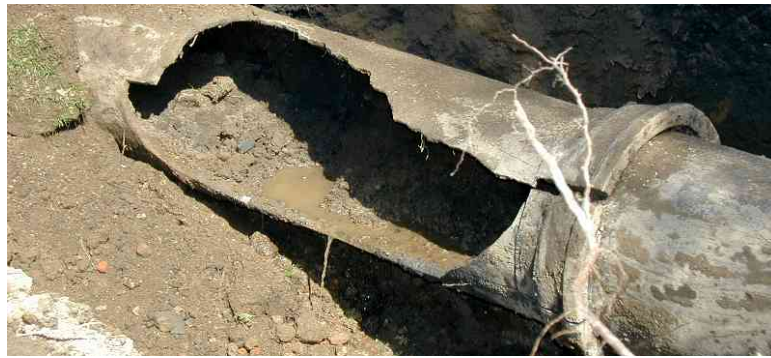
Obr. 2.2 Havárie vodovodu DN 500 v ulici Polní v Brně [85]
