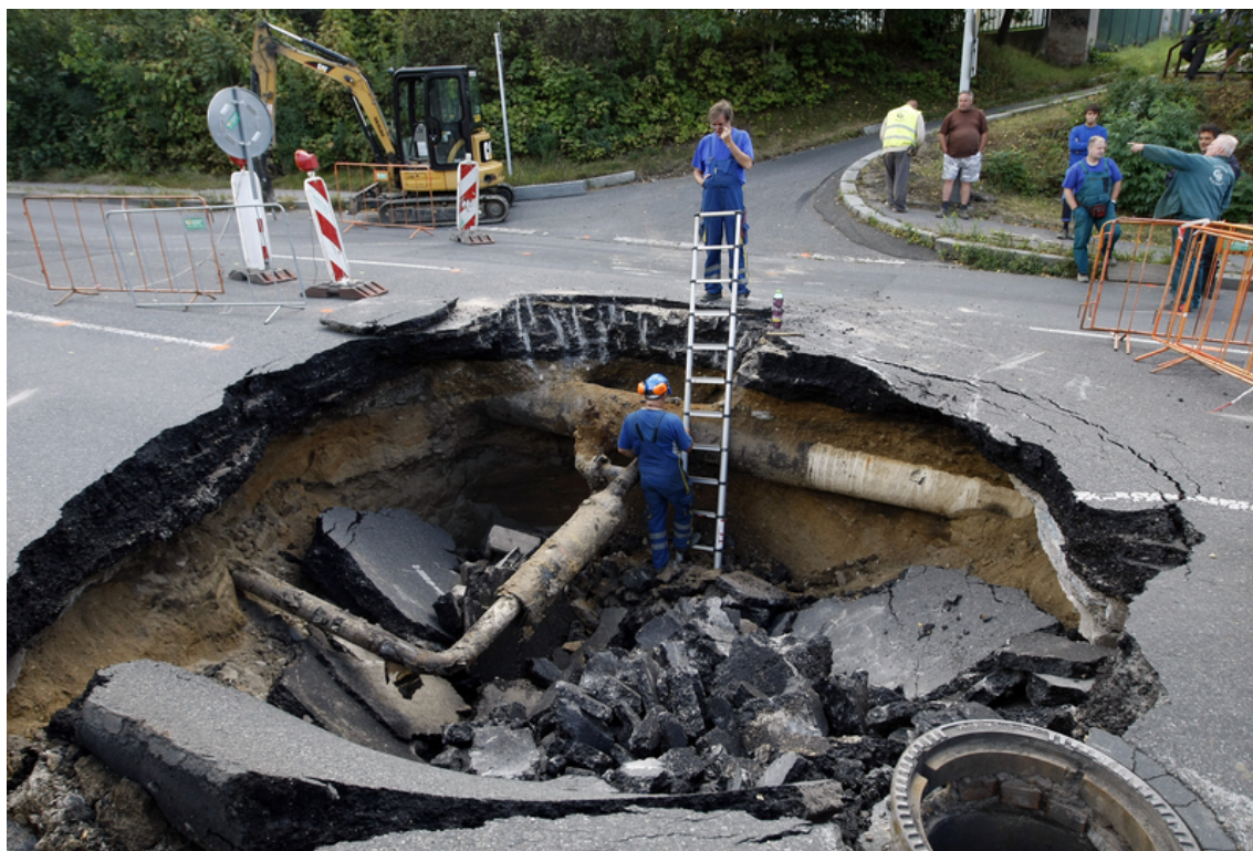
Obr. 2.1 Havárie kanalizace z roku 2012 v ulici Prosecká v Praze [93]
