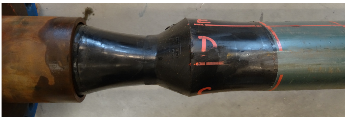
Obr. 14.51 Deformace potrubí - detail (vzorek A-D160-SDR11-BV-1)
