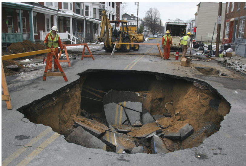
Obr. 2.3 Havárie vodovodu v Harrisburgu v Pensilvánii (USA) [95]
