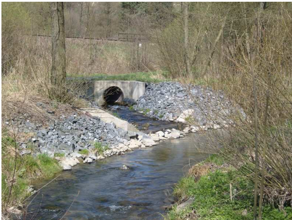
Výpustný profil vyčištěných vod do potoka Nedvědičky
