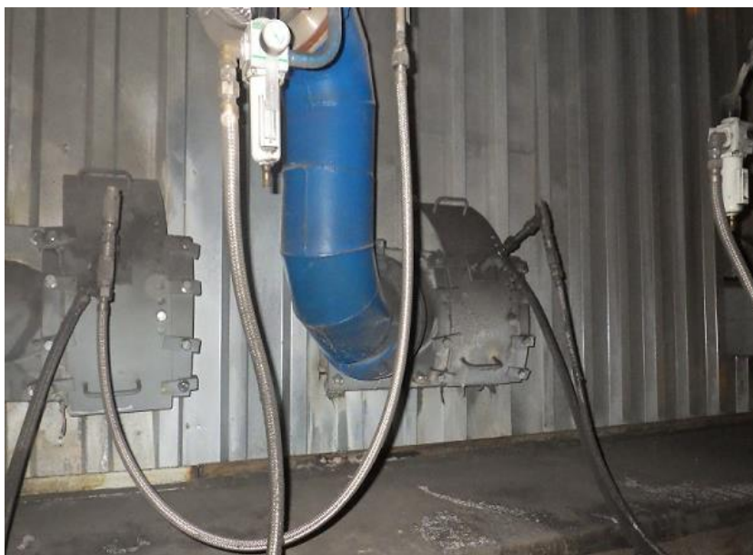
Obr. 21. Vstříky na kótě 40,0m [foto vlastní]
