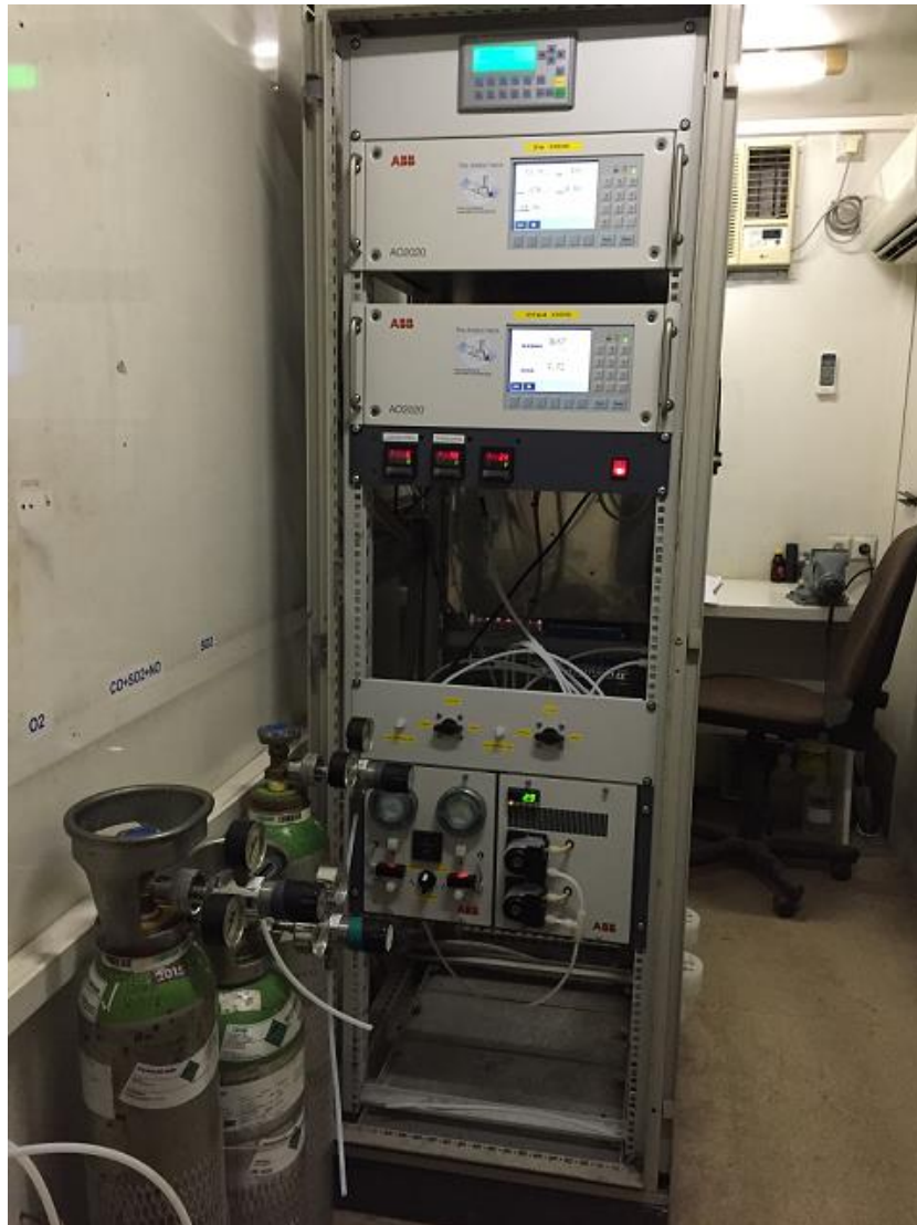
Obr. 13. Měřící stanice ABB u ODS [foto vlastní]
