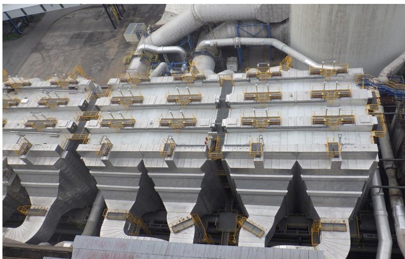
Obr. 12. Elektrostatické odlučovače v 7EC [foto vlastní]
