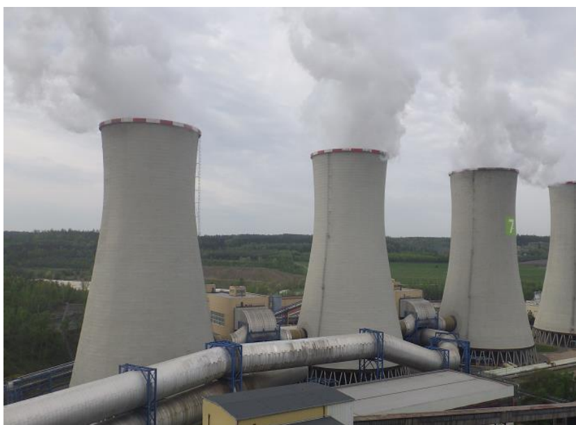
Obr. 11. Pohled ze střechy kotelny na chladicí věže, v průhledu jsou budovy absorbérů odsiřovacích linek [foto vlastní]
