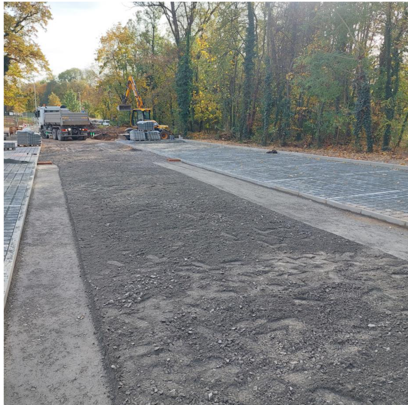
Obr. č. 4. Pokládka propustné zámkové dlažby na parkovišti Borčky v Kolíně (autor, 2023)
