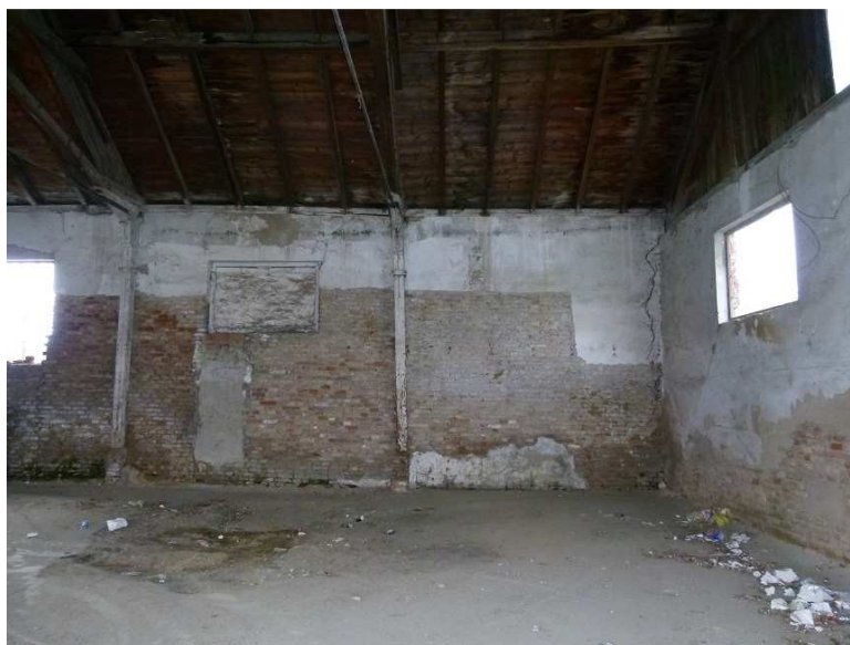
Obr.14: Poškodenie pomúrnic v dôsledku chýbajúceho murovaného pídestálu
