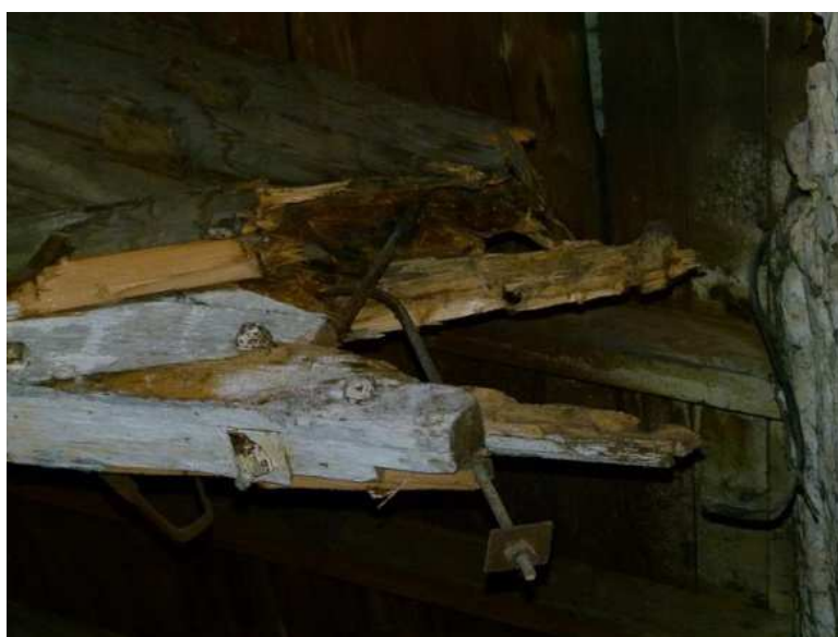
Obr.13: Poškodená pätká prvej plnej väzby
