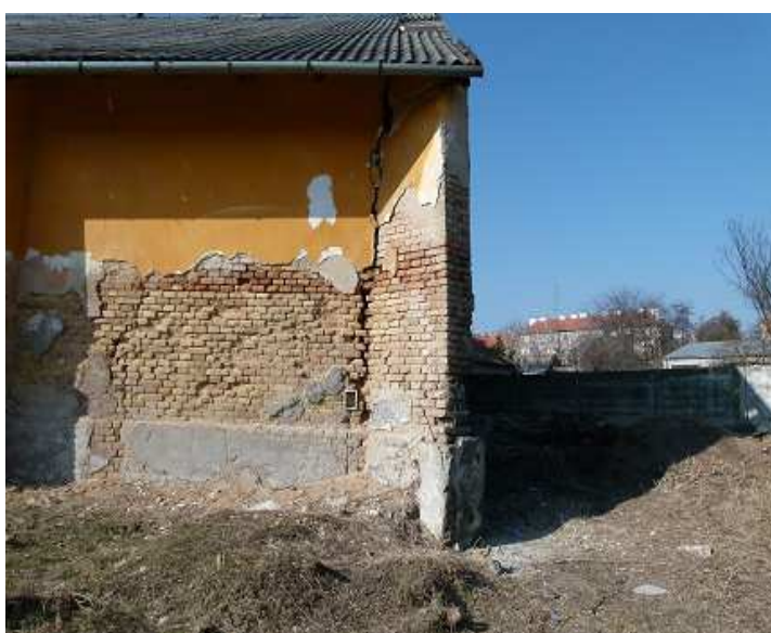
Obr.4: Poškodenie rožného piliera severovýchodnej časti
