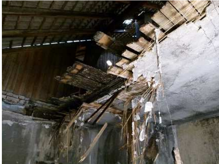
Obr.22: Dezolátny stav stropu miestnosti „001“ (prístavba)
