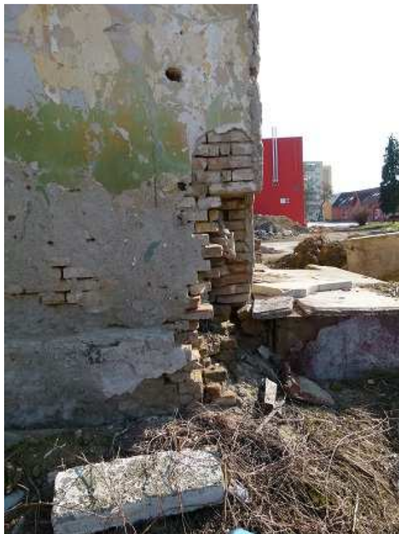
Obr.2: Poškodenie muriva juhozápadnej fasády
