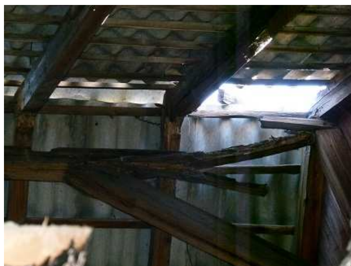
Obr.17: Zničené napojenie hřebeňovej väznice na štítové väzbu prístavby
