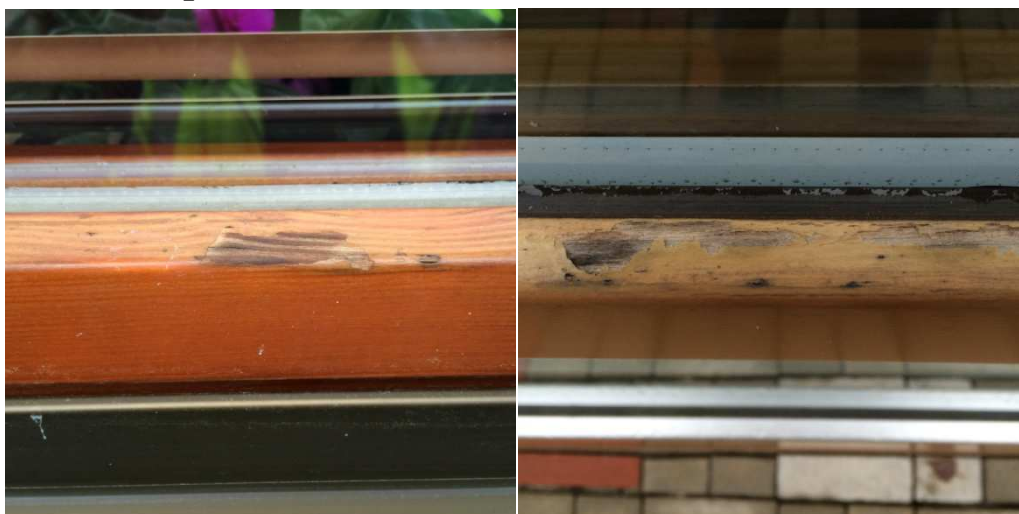
Poškození eurooken krupobitím (Praha-Hloubětín) Foto: Smolný
