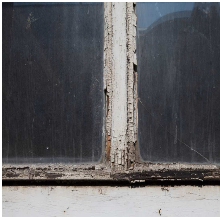
Obr.2 Poškozená špaletová okna. Foto: Pavala
