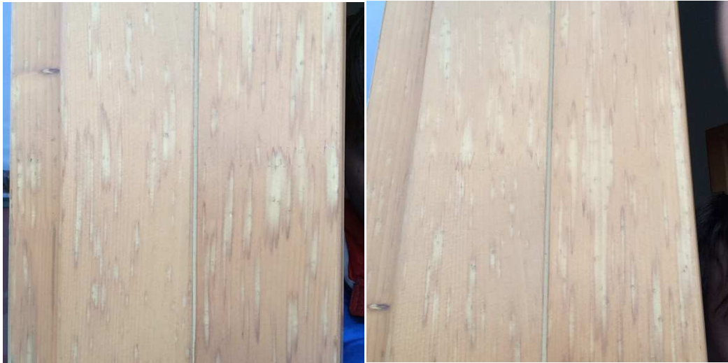
Viditelné poškození povrchu od krupobití (Praha-Hloubětín) Foto: Smolný
