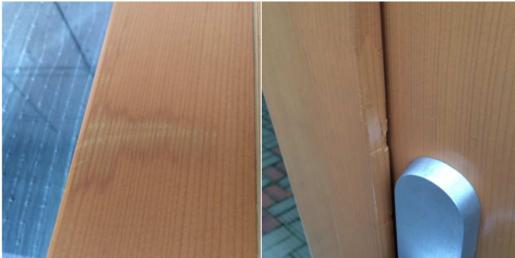
Mechanické poškození eurooken (Praha-Hloubětín) Foto: Smolný
