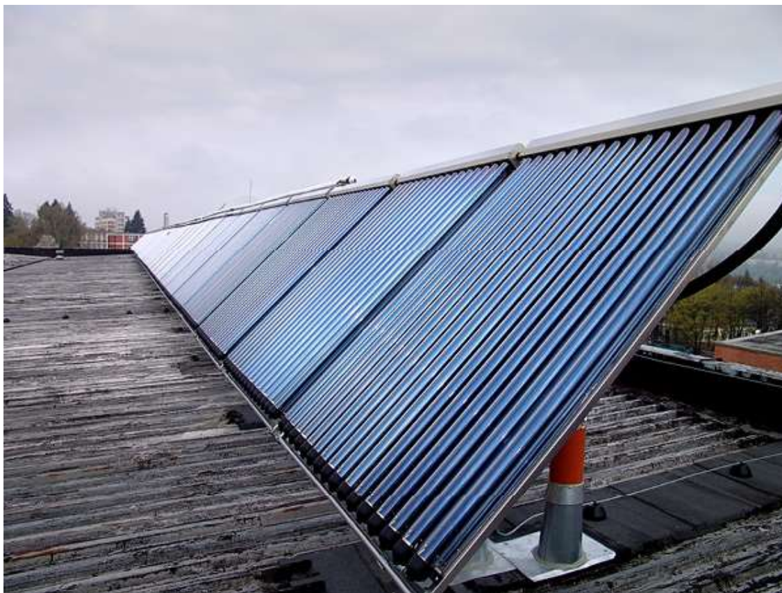
Obr. 8 Vakuové solární kolektory na městských lázních ve Zlíně [22]
