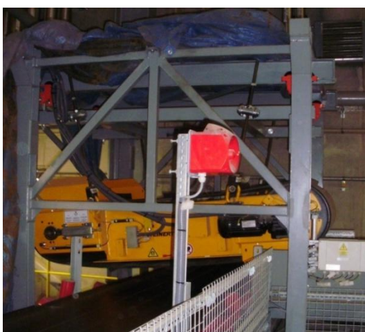
Obr. 13 Elektromagnetický separátor zavěšený na ocelové konstrukci
