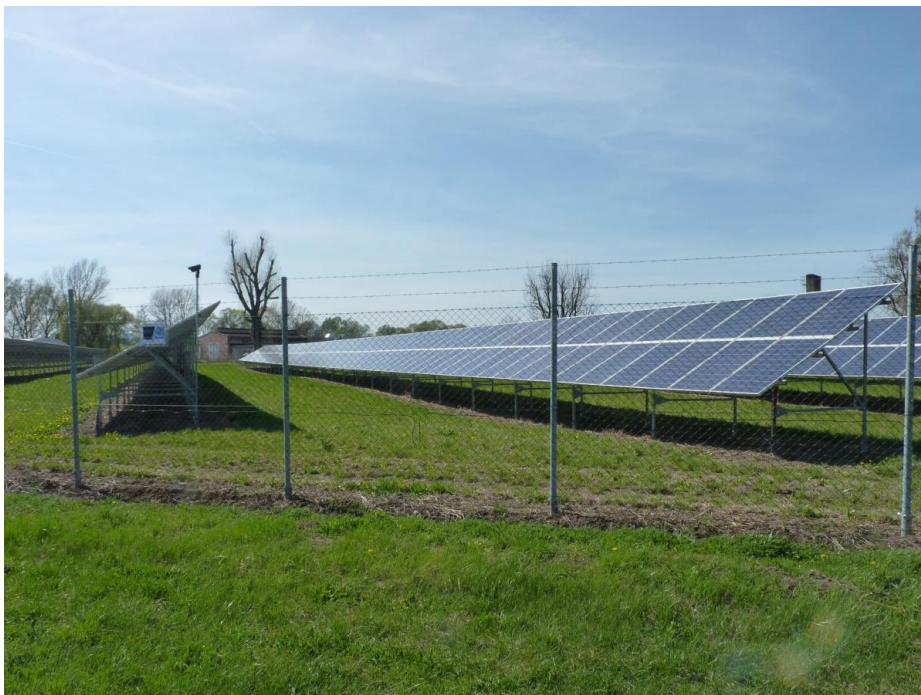
Obr. 11: FVE v obci Babice (zdroj: vlastní foto)
