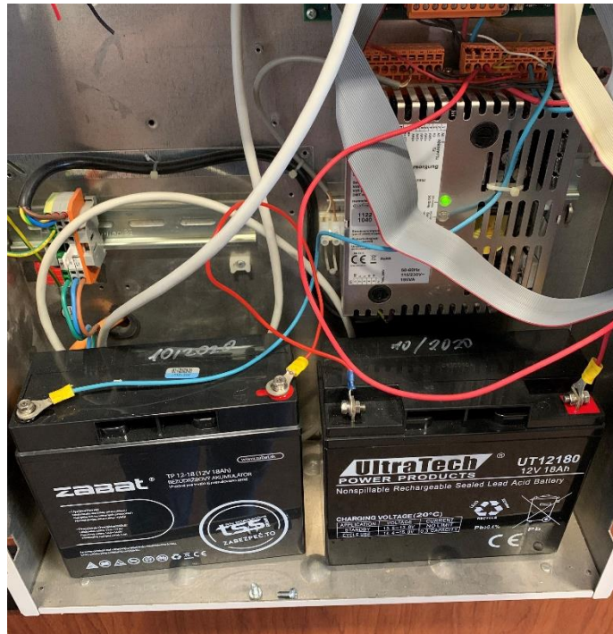
Obrázek 2: Záložní napájecí zdroj systému EPS 4
