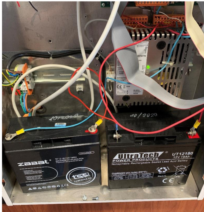
Obrázek 2: Záložní napájecí zdroj systému EPS 4
