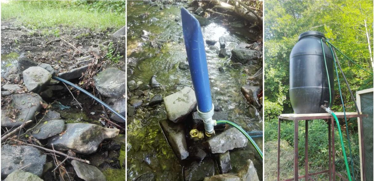
Zleva: vtoková část přívodního potrubí, osazení vodního trkače, zásobní nádrž
