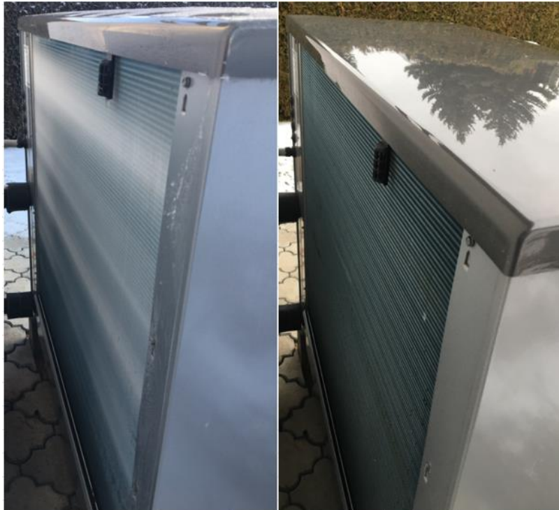
Obrázek 13 Námraza na výparníku tepelného čerpadla vzduch-voda
