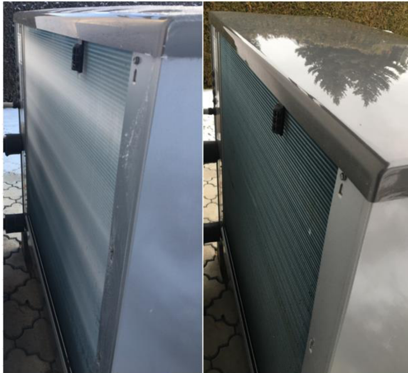
Obrázek 13 Námraza na výparníku tepelného čerpadla vzduch-voda
