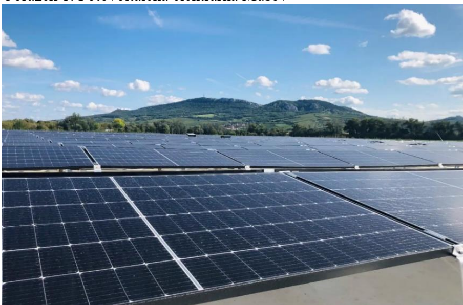
Obrázek 1: Fotovoltaická elektrárna Mušov
