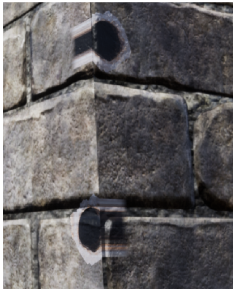
Obrázek 4.7: Stopa po střele na hraně objektu
