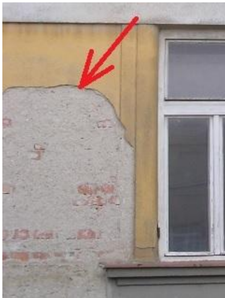
Obr. č. 8 - Odpadlá fasádní omítka způsobená táním sněhu
