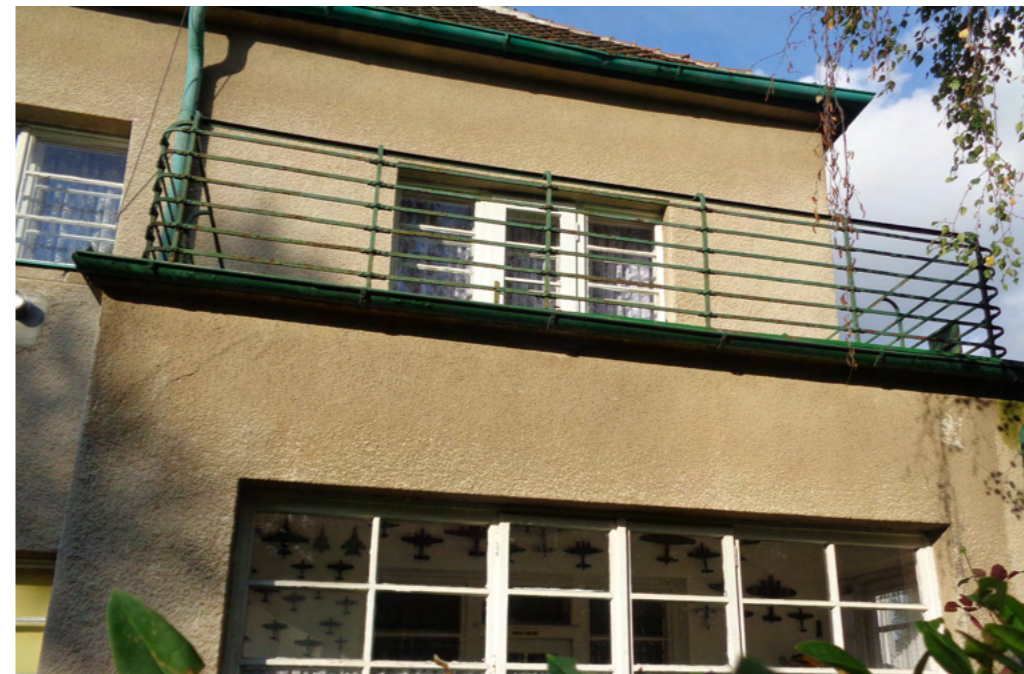
Obr. 72 Původní zábradlí se zeleným nátěrem
