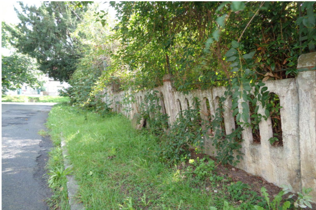
Obr. 101 Původní nerekonstruované oplocení s doplněným kovovým pletivem a živým plotem z ptačího zobu, vychýlené z osy
