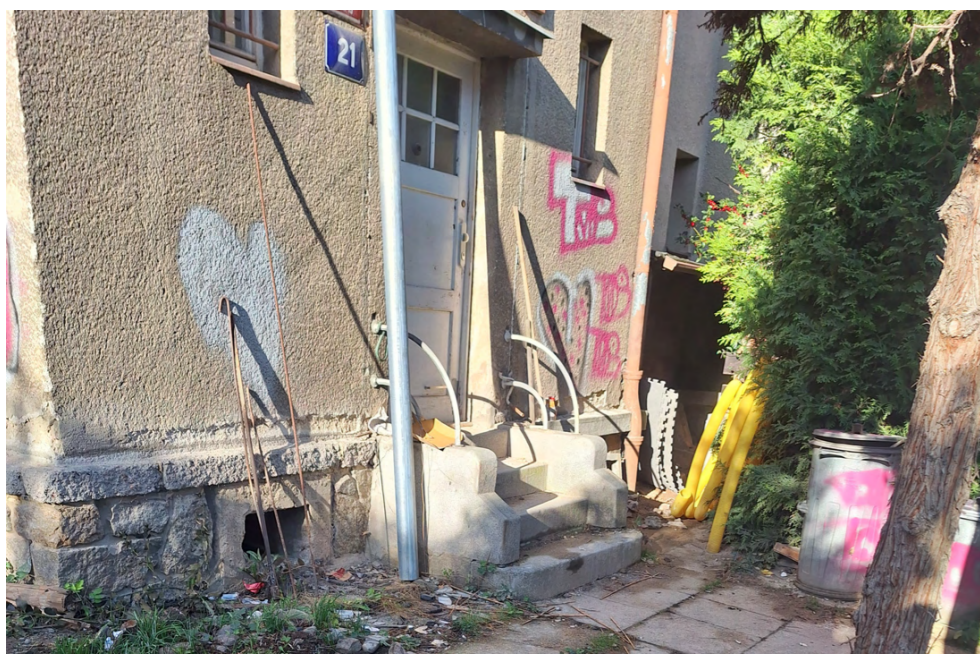
Obr. 117 Zapomenutá chátrající předzahrádka s původním dlážděním a schody, a zábradlím vedoucím k původním vchodovým dveřím
