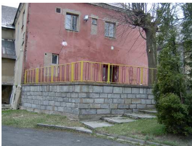
Obr. 21 Budova kina před demolicí s viditelnou prasklinou u oken v roce 2005 (foto: Horní Město, 2012)
