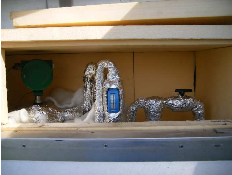
Obr. 11 – Izolace vibračního hustoměru
