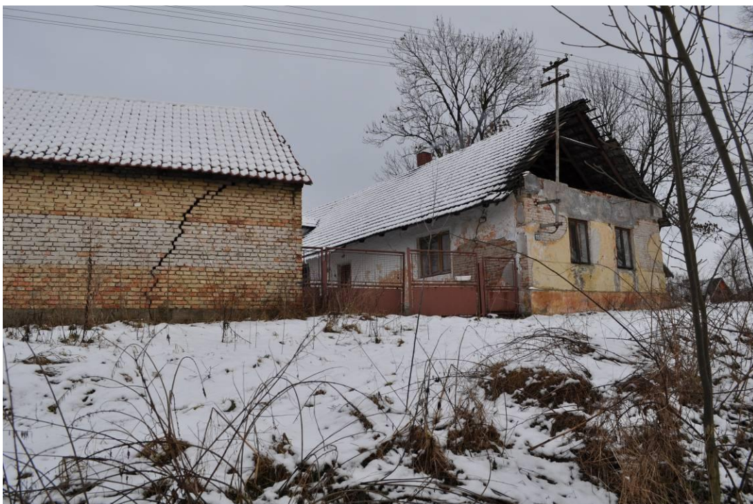
Obr. 15: Objekt s č. p. 15. Jeden ze zástupců chátrajících staveb. V objektu byl do roku 1938 umístěn hostinec.
