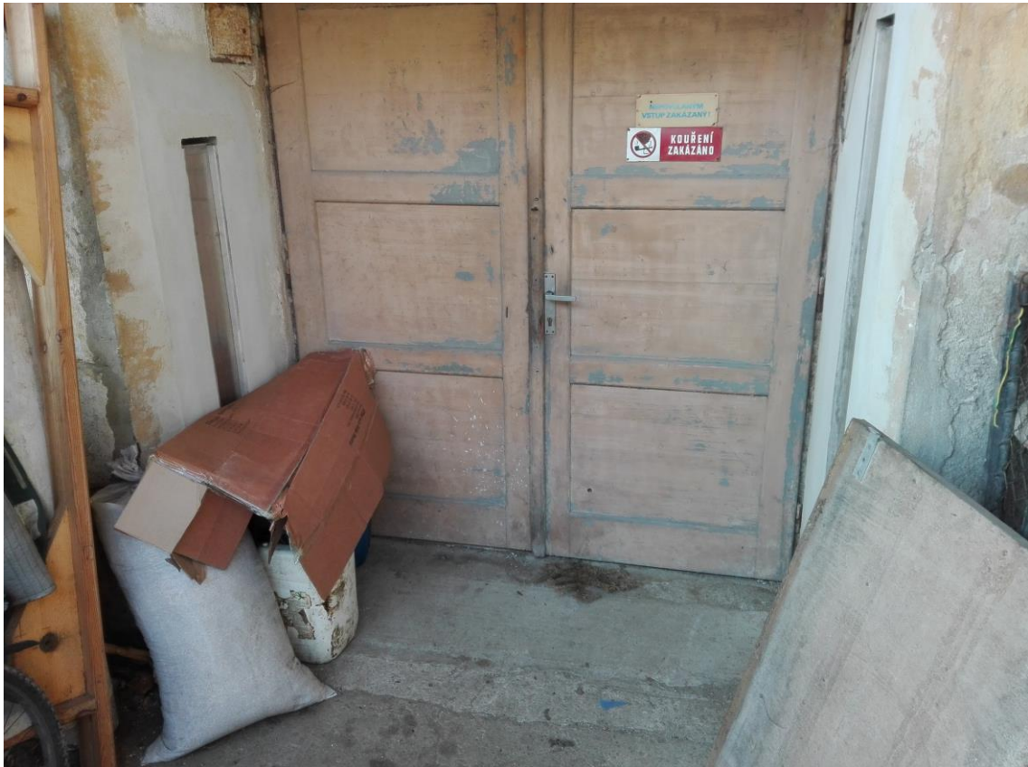
Obrázek 8: Zatarasené montážní otvory u malé vodní elektrárny
