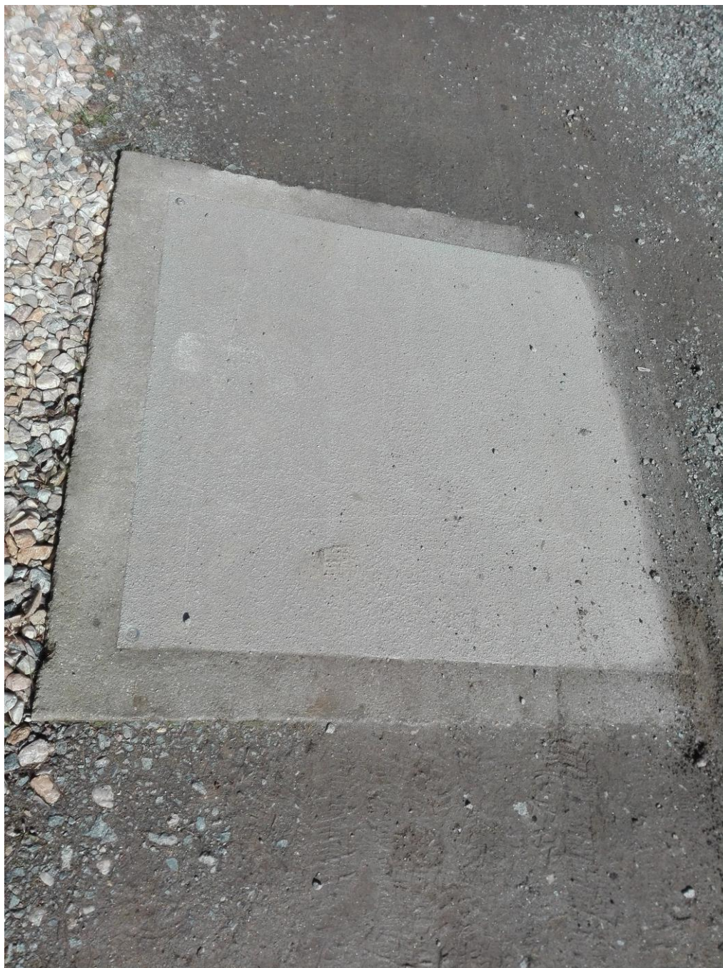
Obrázek 7: Poklop čerpací šachty
