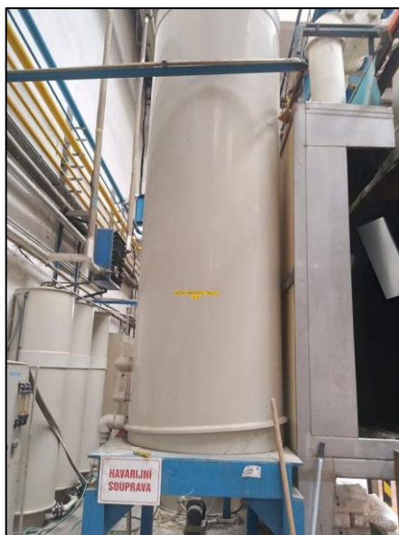
Obr. 22 Nádrž na permeát z ultrafiltračního zařízení
