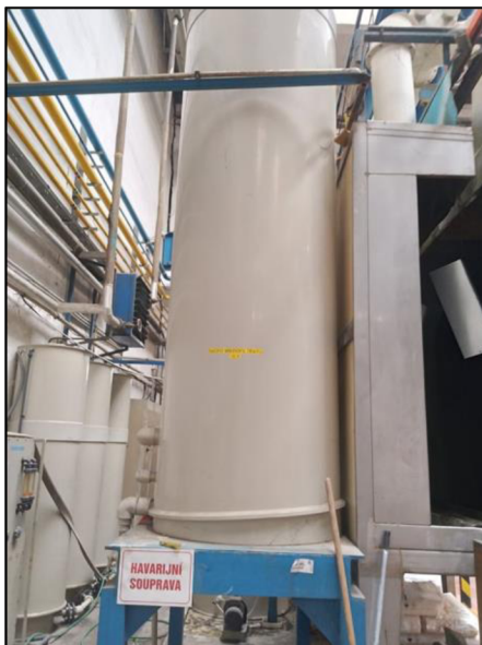
Obr. 22 Nádrž na permeát z ultrafiltračního zařízení
