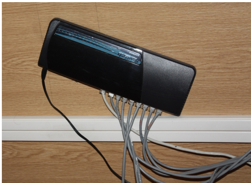
Obr. 15: Switch umístěný pod stolem [Zdroj: Vlastní zpracování]
