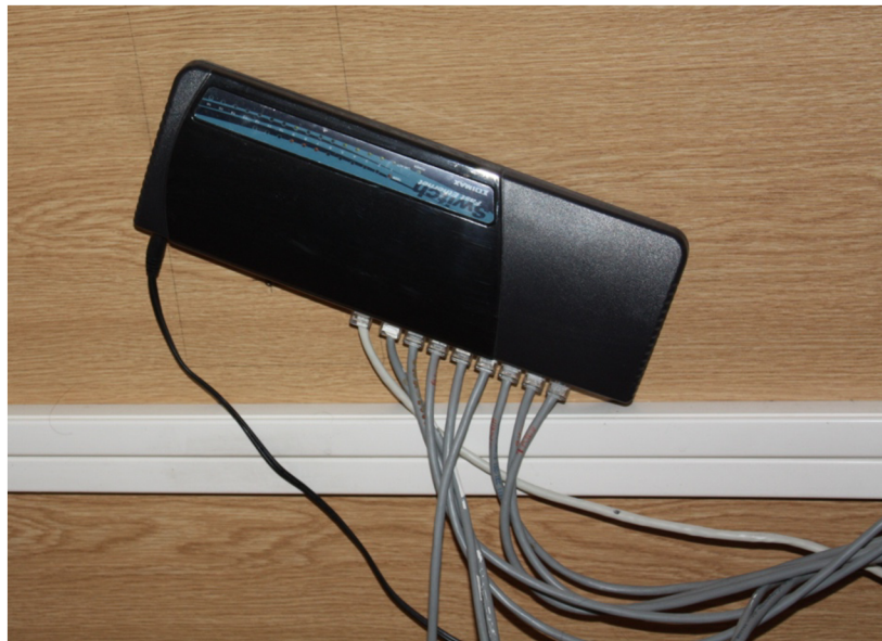
Obr. 15: Switch umístěný pod stolem [Zdroj: Vlastní zpracování]
