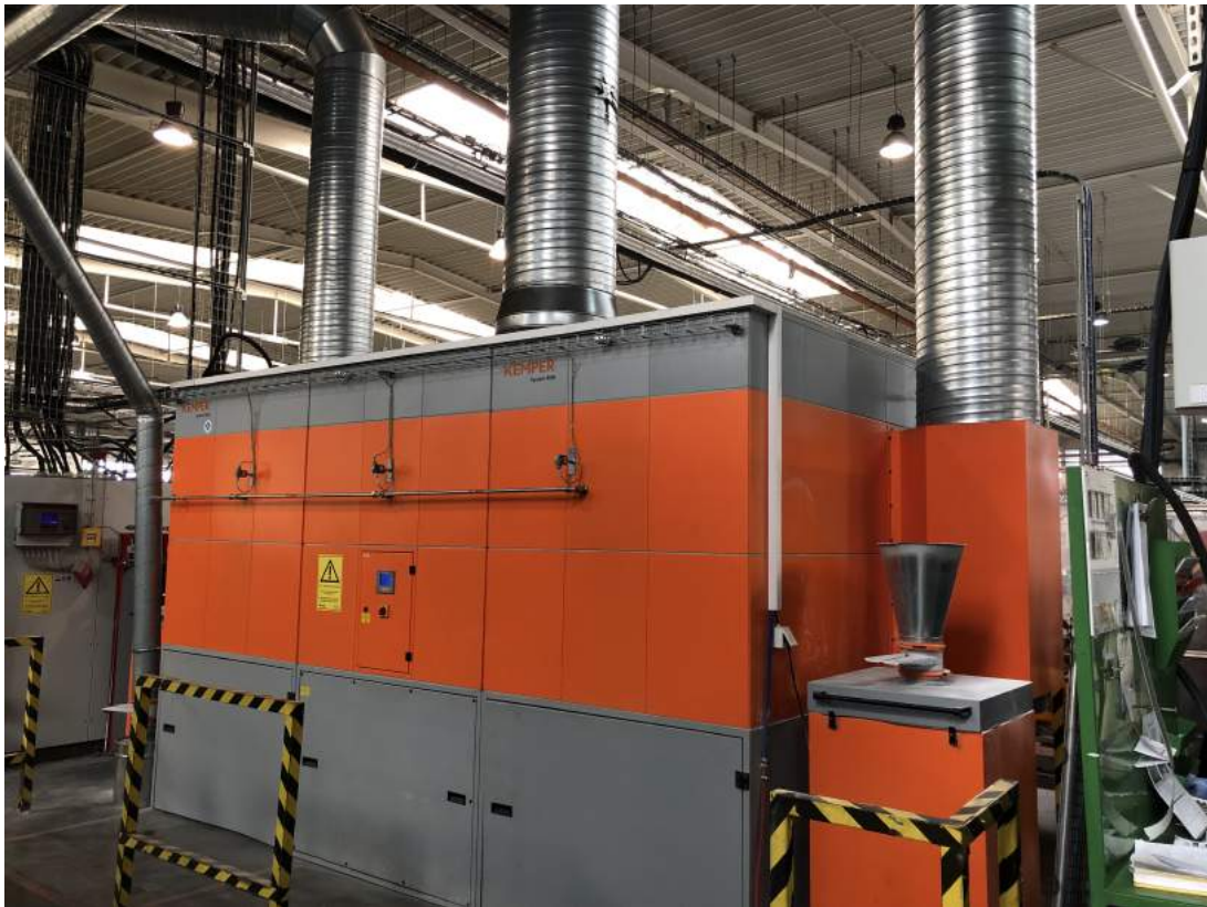
Obrázek 6.19: Filtrační zařízení s připojeným potrubím
