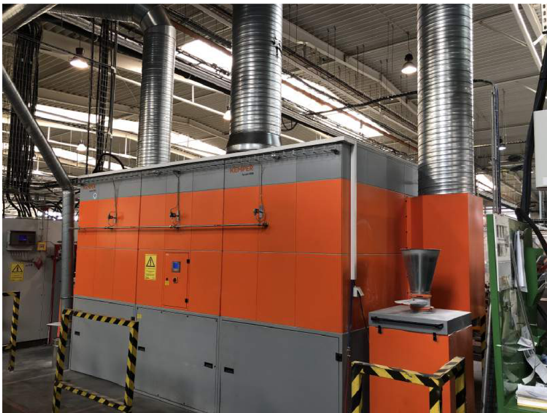
Obrázek 6.19: Filtrační zařízení s připojeným potrubím
