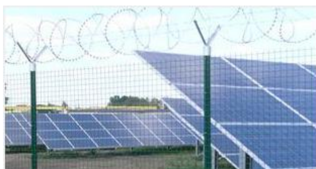
Obrázek 3 Fotovoltaická elektrárna Hrušovany
