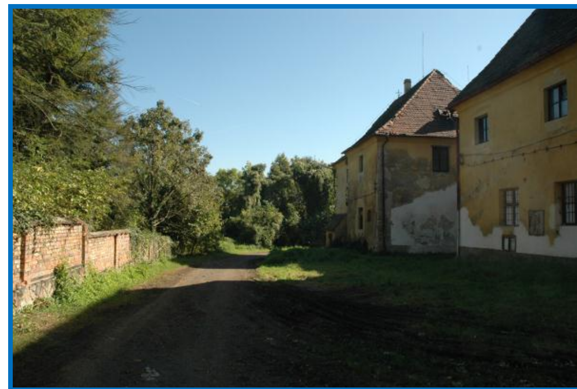
Obrázek 66: Okolo všech budov v areálu vede zpevněná cestní síť, která byla vytvořena armádou. Budova kláštera je ve špatném stavu a nutně potřebuje rekonstrukci. V současné době je vstup do kláštera přísně zakázán z důvodu spadlé střechy a rizika dalšího pádu částí budovy.
