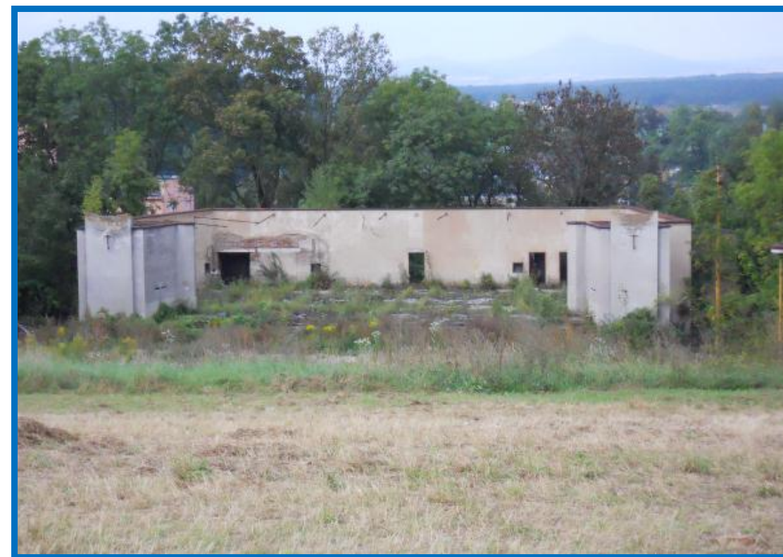
Obrázek 76: Budova divadla je ve velmi zanedbaném stavu. Pro její další využití bude nutná oprava.
