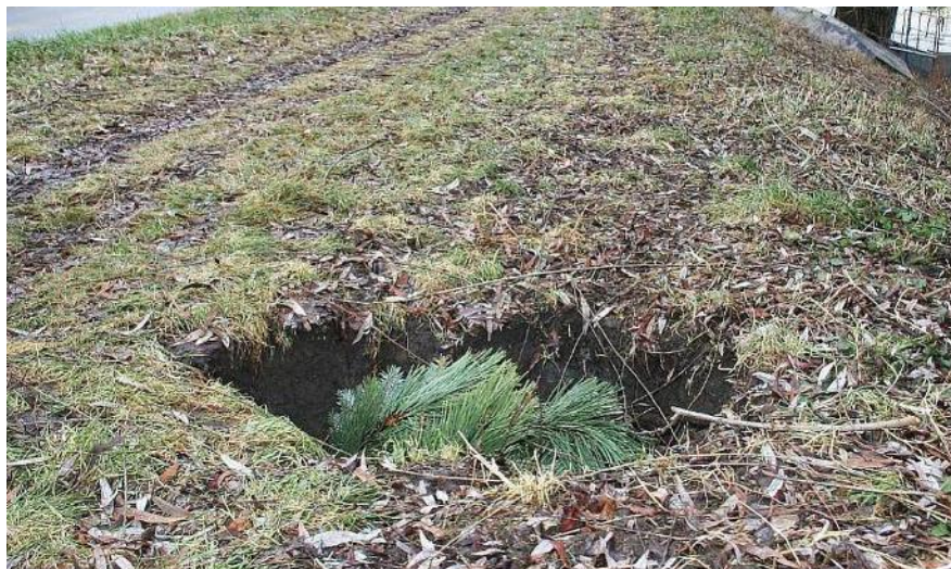
Obr. 1.4. Bobrem narušená hráz [1]
