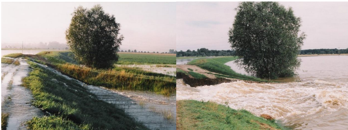
Obr. 1.2 Protržení hráze v důsledku přelití, Lužice povodeň 1997 [13]
