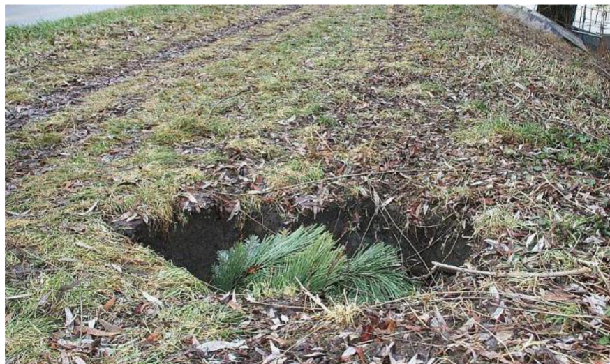
Obr. 1.4. Bobrem narušená hráz [1]
