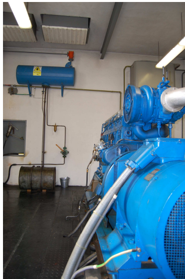
Dieselagregát s nádrží a náhradním palivem
