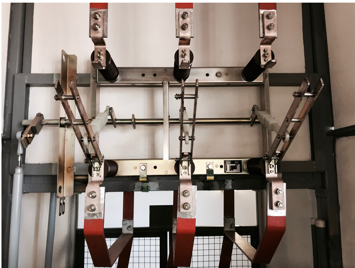
Obrázek 7: Odpojovač 22 kV (opojený stav)
