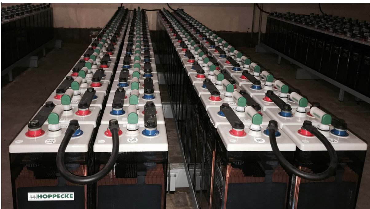
Obrázek 9: Záložní zdroj - soustava akumulátorů
