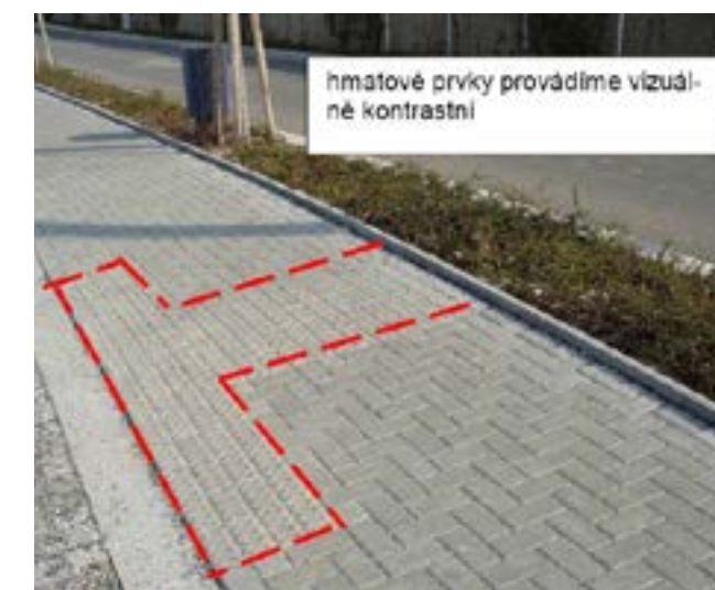
Obr. 22: Hmatový prvek postrádající kontrastní označení
