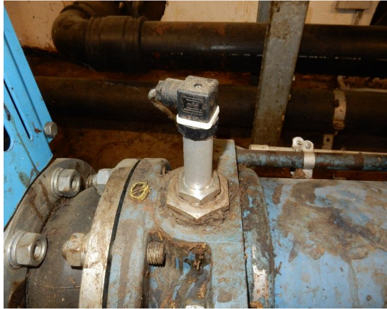
Obr. 29. Měření tlaku na čerpadle [foto vlastní].
