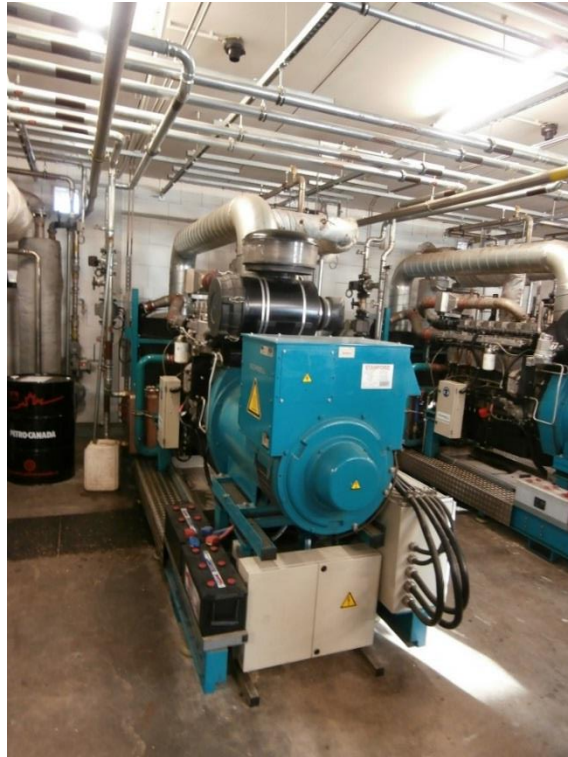
Obr. 22. Strojovna kogeneračních jednotek [foto vlastní], je osazena 2 x 4 KJ H.J.SCHNELL o el. výkonu 250 kW el
