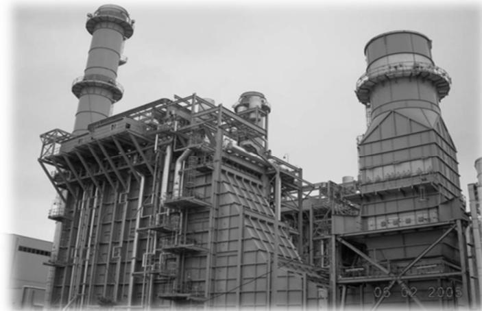
Obr. 2 Kotel na odpadní teplo [14]
