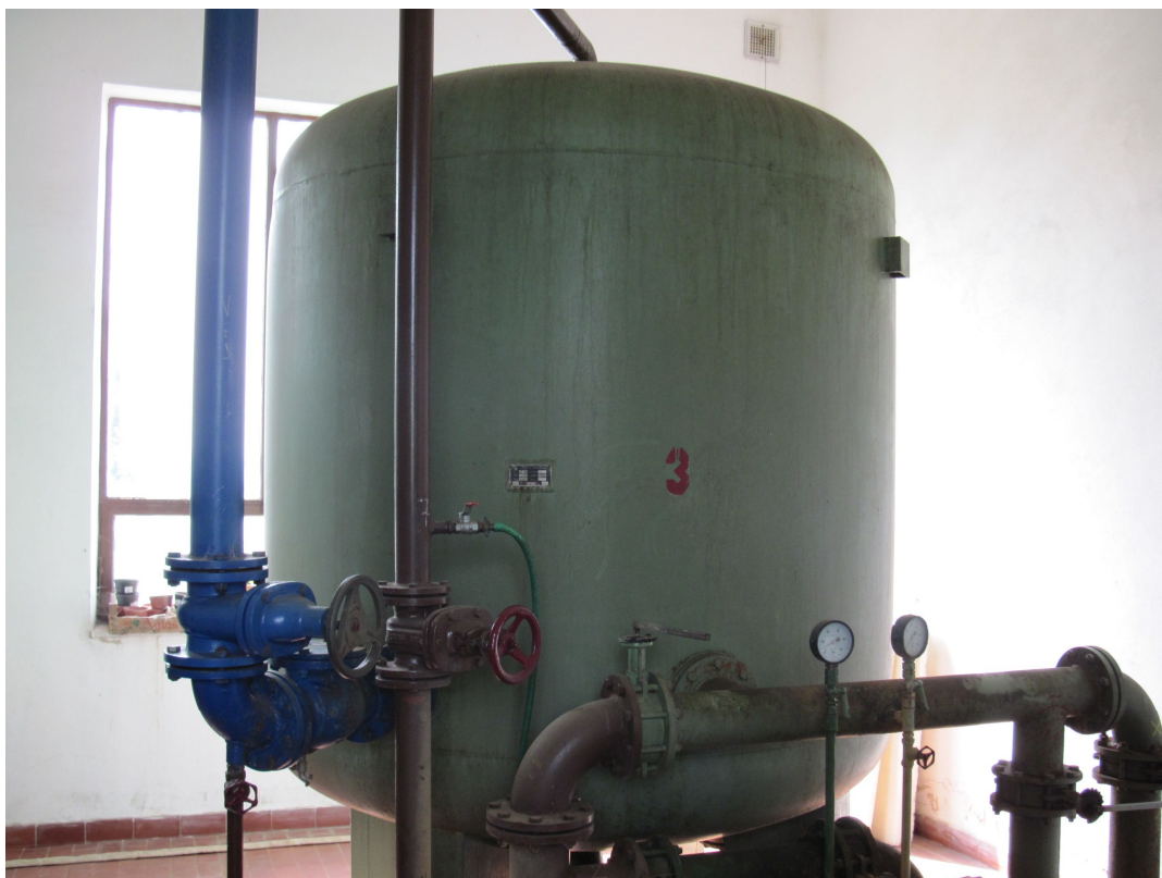
Obr. 5-3 Jeden z odželezovacích tlakových rychlofiltrů
