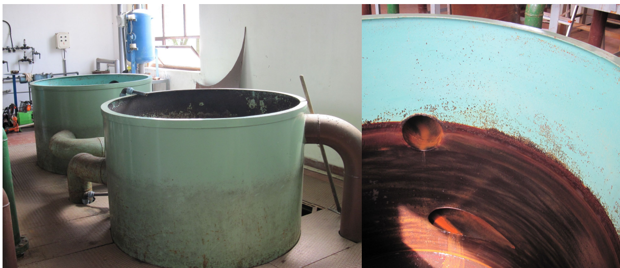
Obr. 5-2 Vločkovací nádrže (dříve míchací – k alkalizaci) a detail tangenciálního vtoku do nádrže
