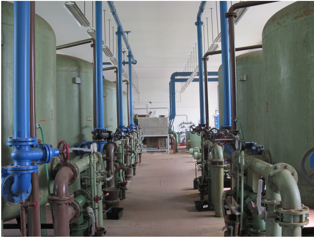
Obr. 5-4 Pohled na odželezovací a odmanganovací tlakové rychlofiltry
