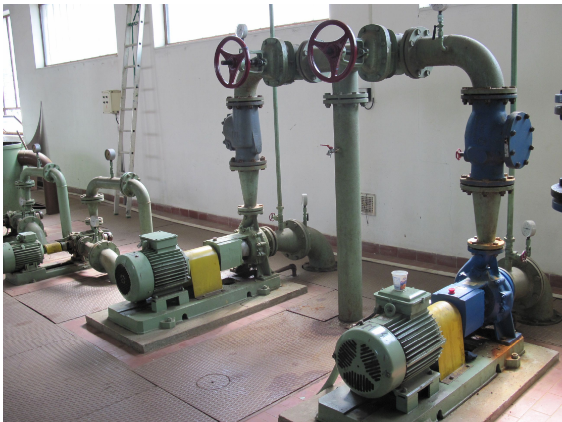
Obr. 5-5 Dvojice čerpadel k čerpání vody na rychlofiltry
