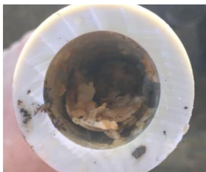
Obr. 3: Zanášení plastového potrubí [13]
