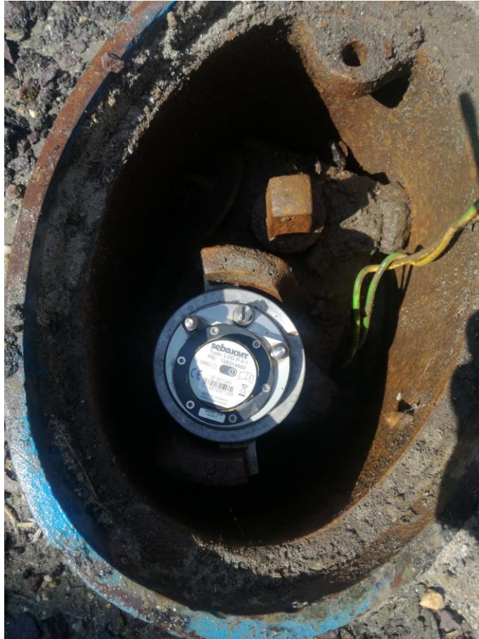
Obr. 11: Tlakové čidlo Sebalog P-3 osazené v podzemním hydrantu
